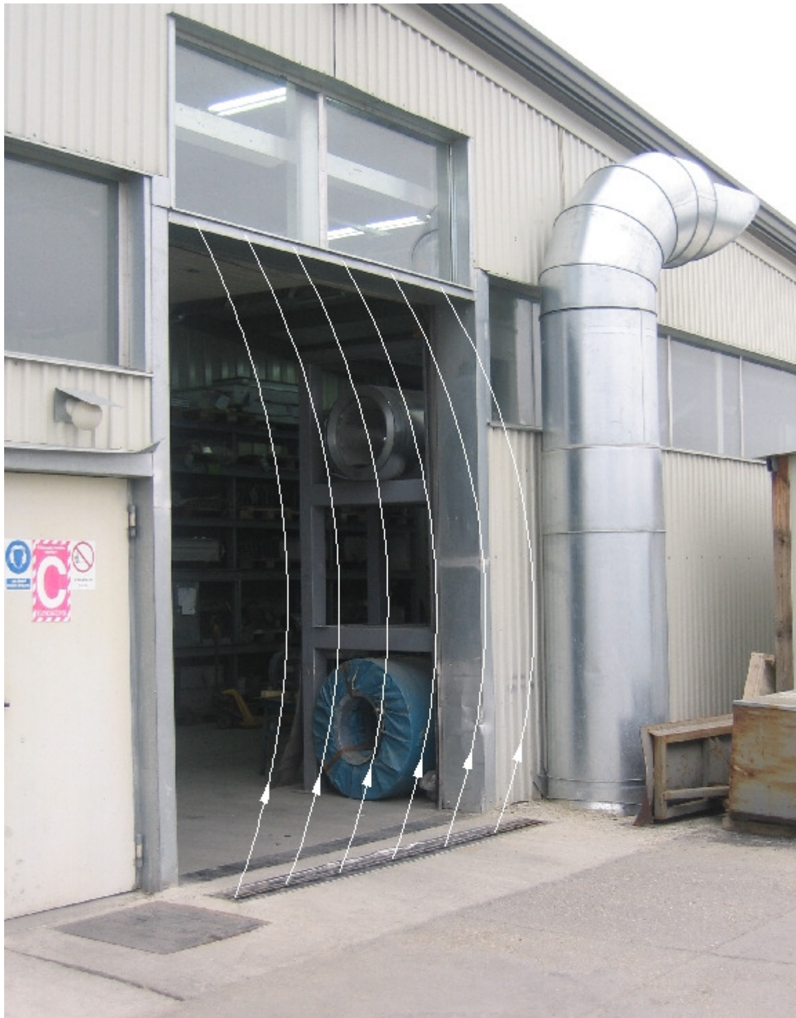
1. ábra Alsó befúvású üzemcsarnok légfüggöny (TROGES Air-Technik Kft.)
