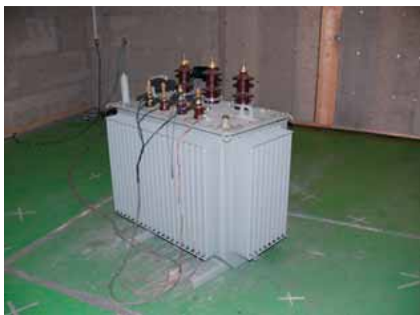
1. ábra. Olajtranszformátor mérésre előkészítve Fig. 1: Oil transformer, prepared for measurement
