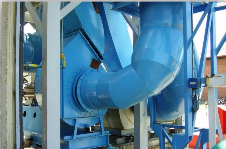
Kazán égési-levegő ventilátor
